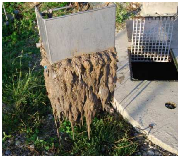
Lingettes agglomérées dans un poste de relevage
